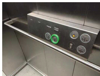
Aufzug von der Tiefgarage zum Vorplatz
